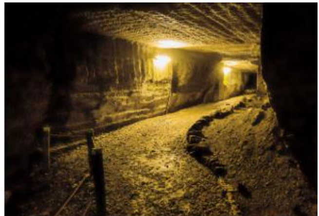
中に入ると壁や天井に筋が… この筋はなんだ？
